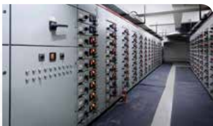
对关键设备进行连续监控
